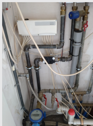
Varmeinstallation i nr. 52E
