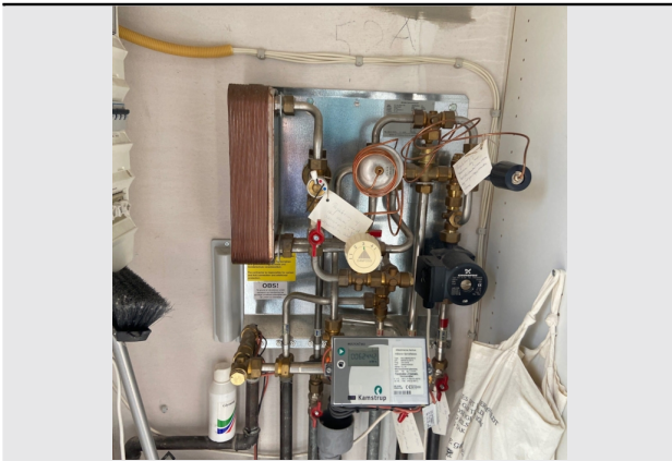
Varmeinstallation i nr. 52A
