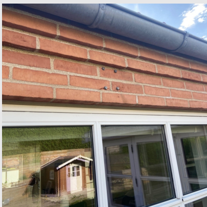
Revner i murværk som følge af ophængning
