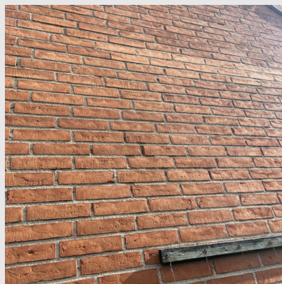
Dårlige fuger i sydgavl ved bygning 6F
