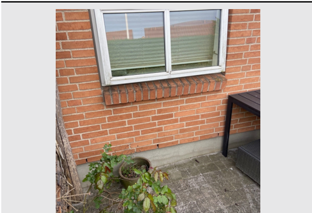
Vindue i træ fra 2003, som trænger til overfladebehandling
