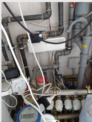
Varmeinstallation i nr. 52C
