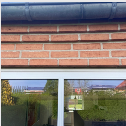
Mindre revne i tegloverligger
