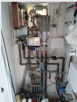
Varmeinstallation i nr. 52F
