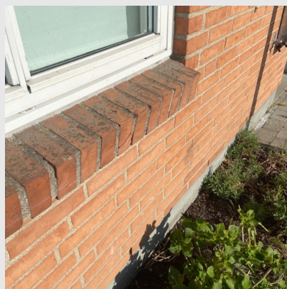
Sålbænk i teglsten fremtræder med revne og alger
